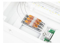
Mehrpole, lagefixierte Verdrahtung einer Leuchte
